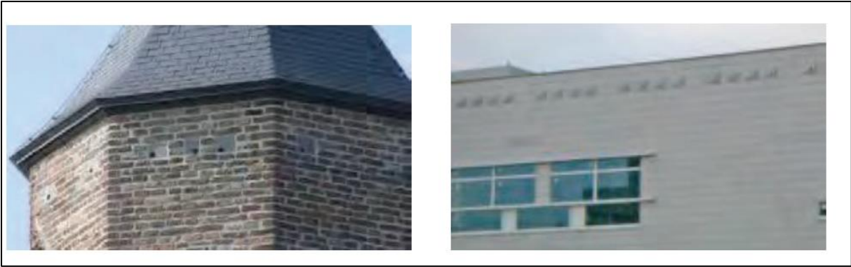
Figuur 3: Inbouwstenen zichtbaar en onzichtbaar ingemetseld.
